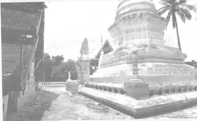
ภาพที่ ๑๙ เจดีย์ประธานด้านหลังวิหารหลวงวัดเวียง เป็นแบบศิลปะล้านนาตอนต้น โดยพิจารณาจากแผนผังการจัดกลุ่มเจดีย์ มีเจดีย์ประธานอยู่กลาง และมีเจดีย์ประจำด้าน ๓ ทิศ คือ ทิศเหนือใต้ และตะวันตก ส่วนทิศตะวันออก ใช้ตำแหน่งของวิหารหลวงเปรียบเสมือนเจดีย์ประจำทิศตะวันออก แต่แบบศิลปะส่วนที่เป็นองค์ระฆังถึงส่วนยอดเจดีย์เป็นส่วนใหญ่ถูกซ่อมแซมโดยช่างล้านนาประมาณ ๑๐๐ ปีที่แล้ว
